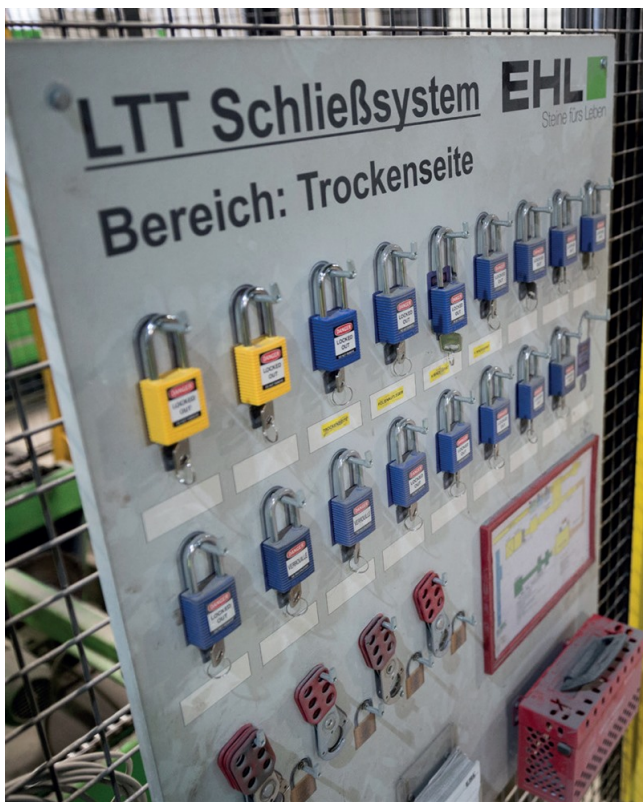
Konsequente Absicherung der Bereiche durch Schlösser.
